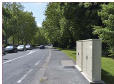
Une armoire de distribution
